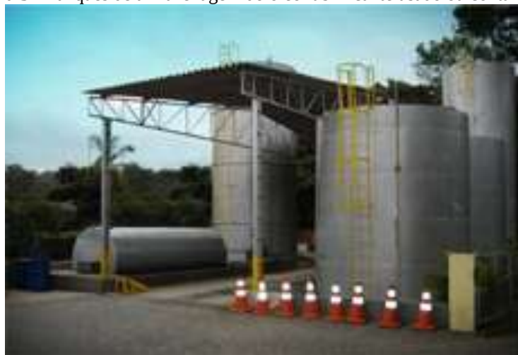
Figura 3 - Tanques de armazenagem do óleo lubrificante usado ou contaminado
